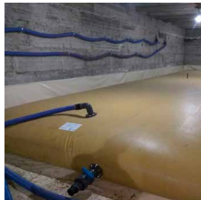
СКЛАД ХРАНЕНИЯ КАС ИЗ 4-Х ГИБКИХ РЕЗЕРВУАРОВ ОБЩИЙ ОБЪЕМ - 335 м 3
